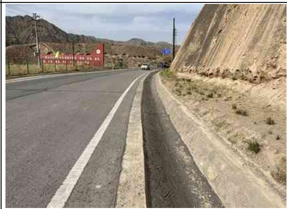
路基区排水设施
